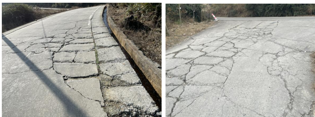
图 2-4 部分农村公路路面损坏严重
