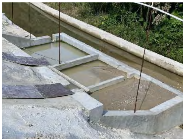
沉淀池未及时清理
