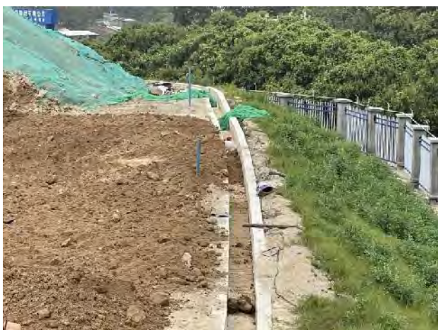
土方掉落沟内易造成淤堵
