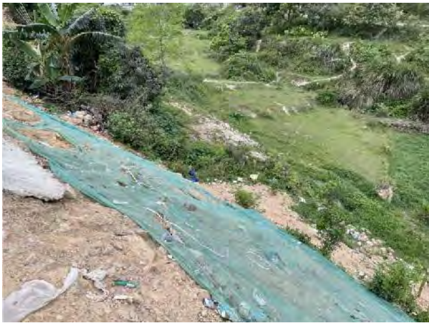
排水出口无沉沙池布设
