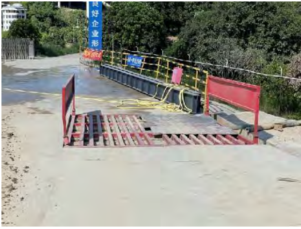
洗车池运行正常
