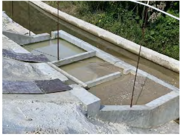
沉淀池未及时清理
