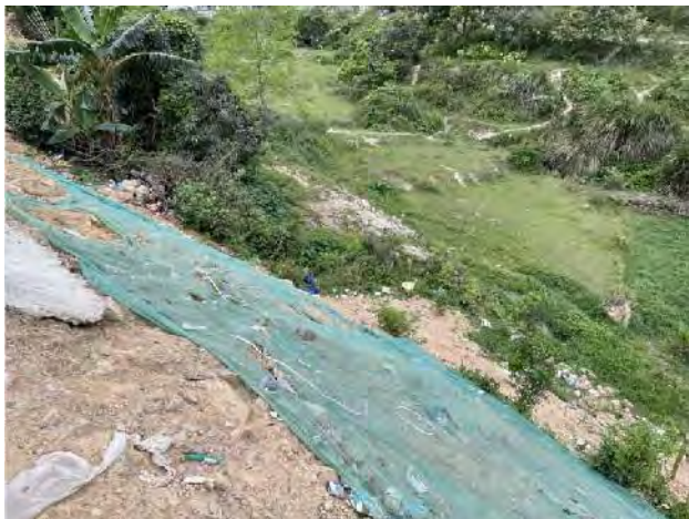
排水出口无沉沙池布设
