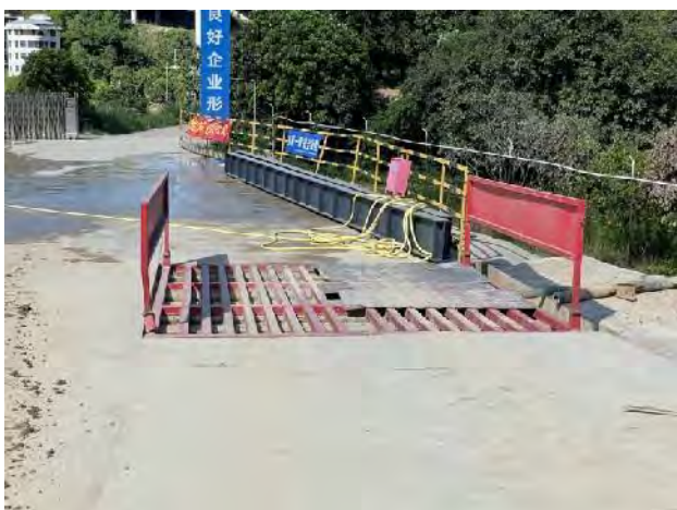
洗车池运行正常
