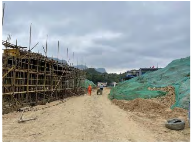
土方中转场坡脚无编织土袋拦挡、无排水沉沙措施
