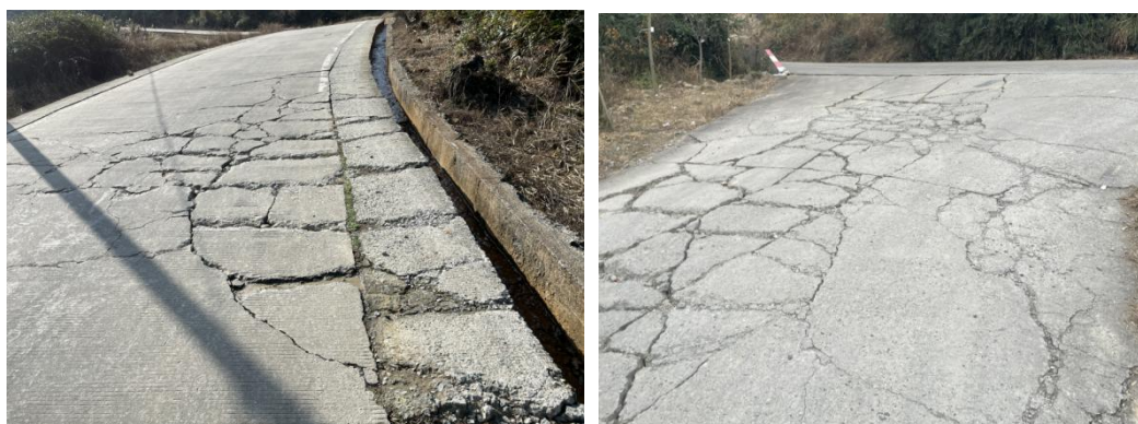
图 2-4 部分农村公路路面损坏严重
