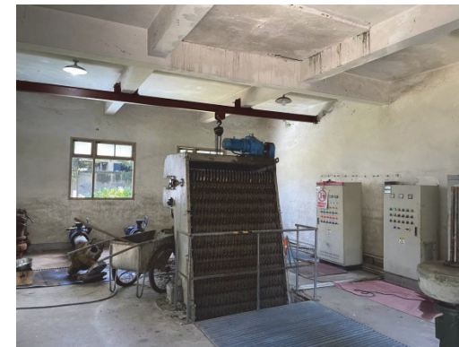
一期进水泵房
