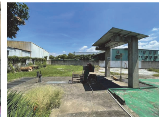
二期进水泵房
